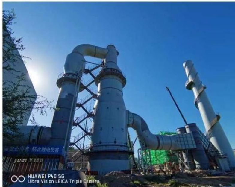
北京首钢股份有限公司迁钢脱硫钢渣处理 及转炉渣钢处理一次处理车间除尘系统
