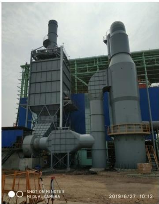
武钢四炼钢钢渣处理湿式变流 除尘系统+湿式电除尘超低排放系统
