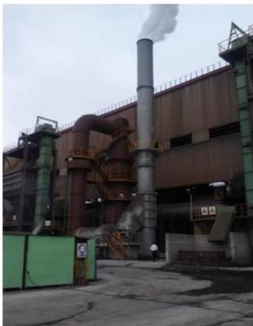
宝钢一炼钢渣处理渣处理 湿式变流除尘系统
