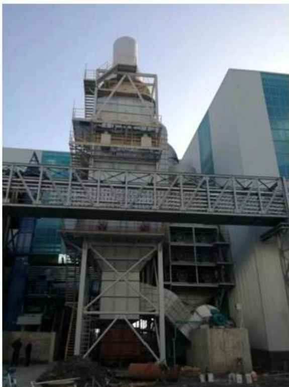
山东莱钢永锋 1#、2#钢渣处理湿式 变流除尘及湿式电除尘超低排放系统+烟羽脱白系统
