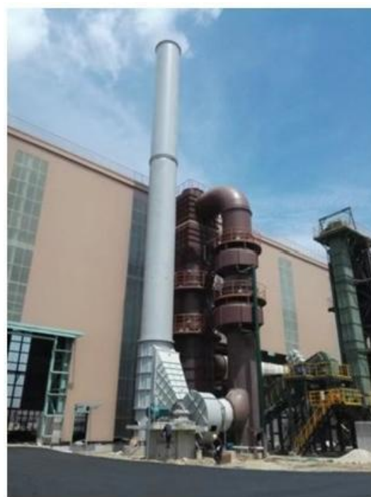
宝钢湛江铸余渣钢渣处理 2#渣处理 湿式变流除尘系统
