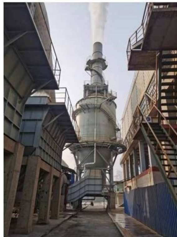
唐山丰南纵横炼钢厂二、二车间钢渣处理 湿式电除尘超低排放系统
