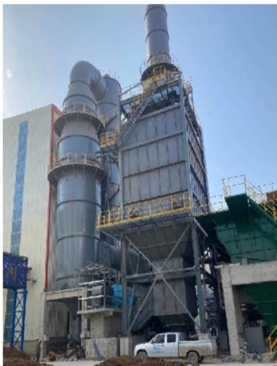
山东石横特钢渣处理除尘及超低排放系统
